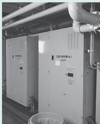
レークサイド桜岡の冷温水発生機
