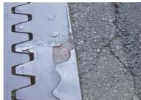
写真3 伸縮装置の欠損
