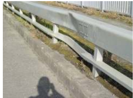
写真2 防護柵の著しい変形
