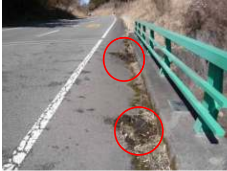
排水樹の土砂詰り（清掃前）
