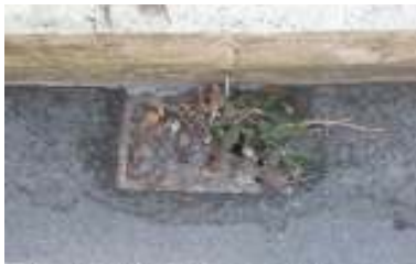
土砂詰り状況
