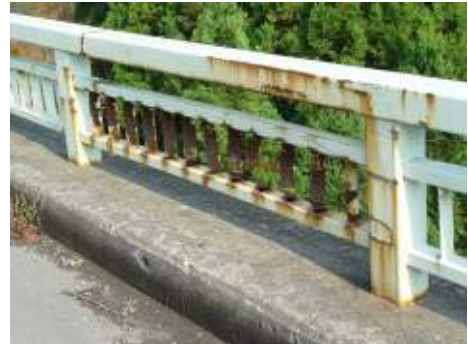
写真1 高欄部材の欠損
