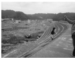
▲田老地区の『スーパー堤防』洪水や地震に対して安全な幅の広い堤防も、山側(図左)から守れなかった。
