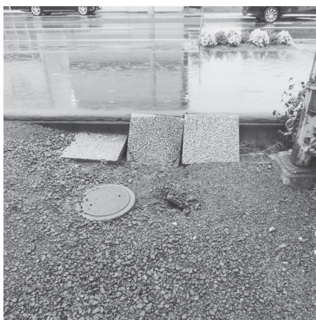
砂利の流出で年々段差が大きくなる
