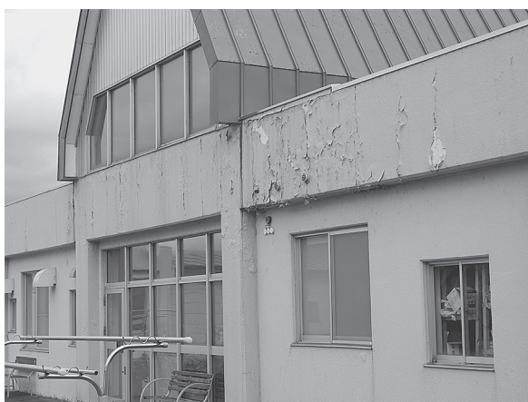
西原学園の外壁状況
