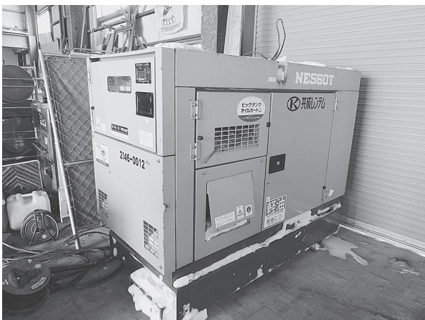
発電機 定格出力40～60KVA
