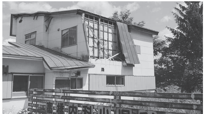
損傷が進む空き家
