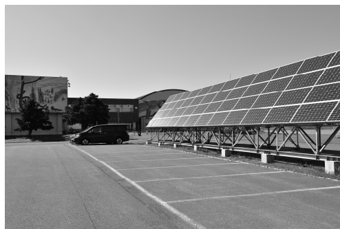
▲小学校に設置されているソーラーパネル
